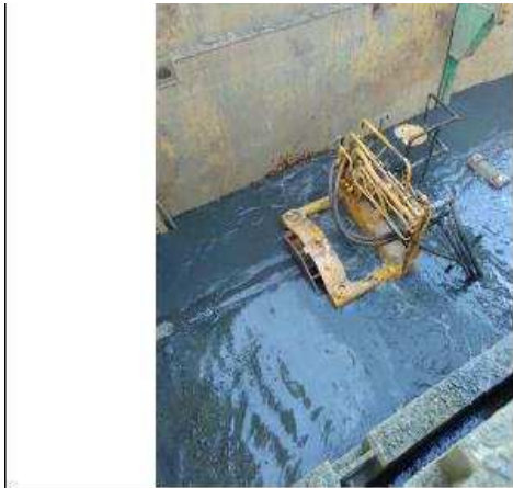
Photo n°1 : Fosse d'entrée immergée du forage du Canut, DLE.
