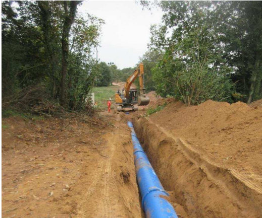
Figure 151 : Réduction de l'emprise de travail lors de la traversée de haies (Tranche 3)
