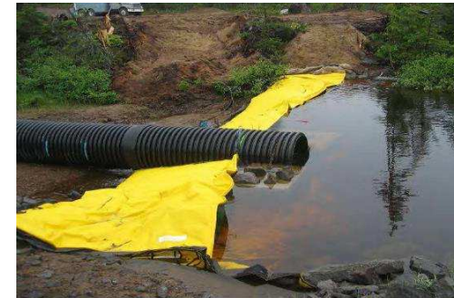
Figure 139 : Exemple de batardeau souple
